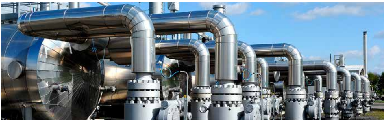
Übertageanlage Tavernenspeicher bei der KGE Epe.
